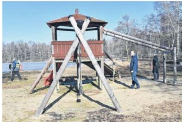
Erst der Teich, jetzt das Umfeld: Mitarbeiter der Firma Kampfmittelräumung Teltow durchsuchen das Gelände. Dabei wird auch der Spielplatz abgerissen, um dessen Fundamente freizulegen. Im Bild Tobias Jaster und Hubertus Raddeck (r.v.l.) von der Stadtverwaltung. FOTO: ECKARDT MILDNER
